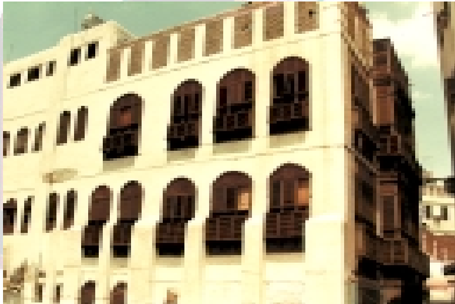
واجهة تكرارية فيها أنواع من الرواشين والنوافذ، مع أعمال النورة في الواجهة الغربية للمدرسة الصوليتية بحارة الباب في مكة المكرمة
